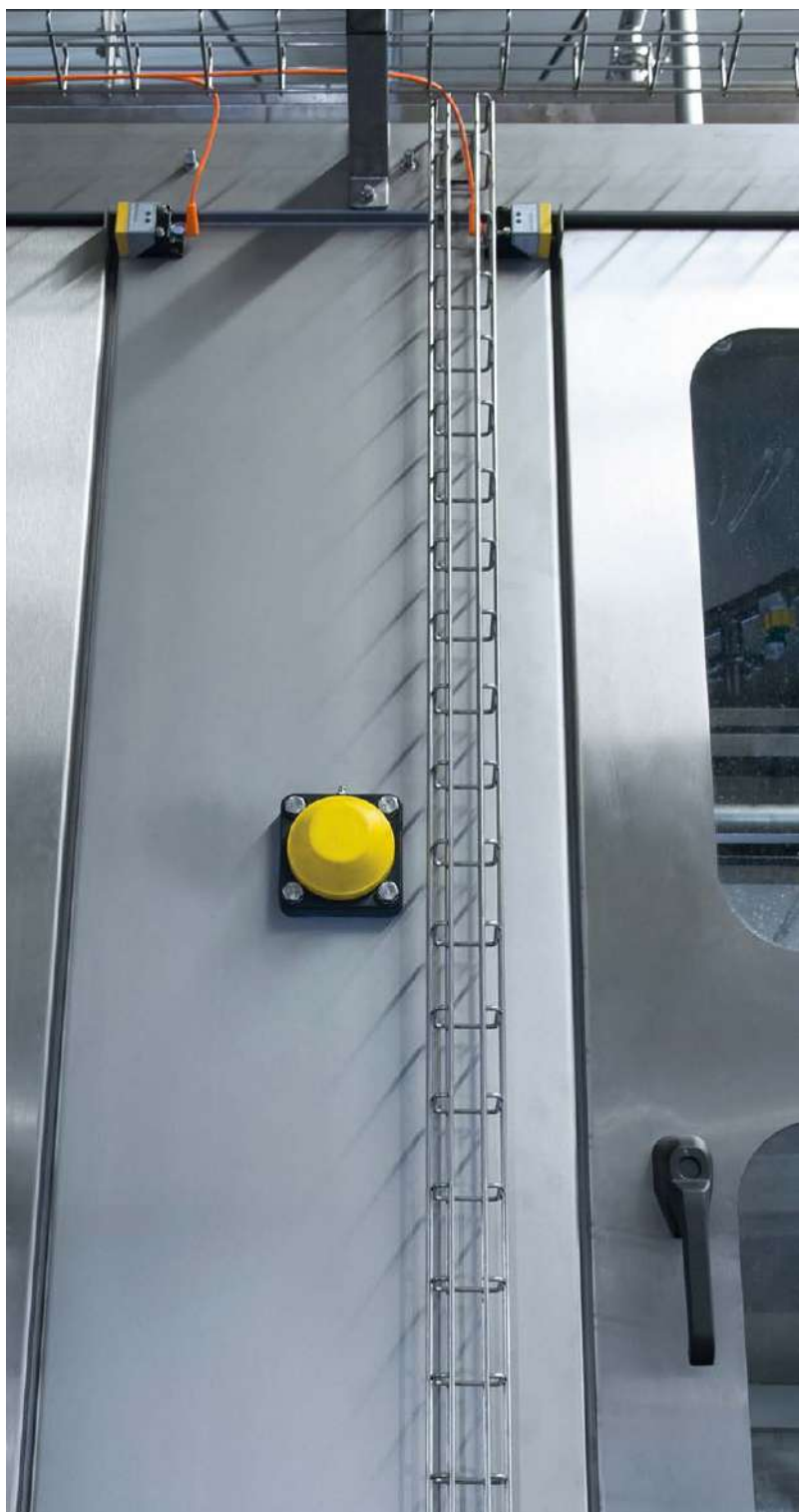
Las puertas de la instalación se supervisan con detectores inductivos de seguridad.
