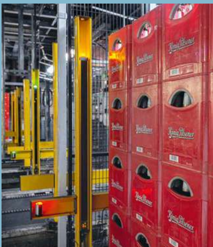
Barrera fotoléctrica de seguridad en un elevador de palés de una fábrica de cerveza.
